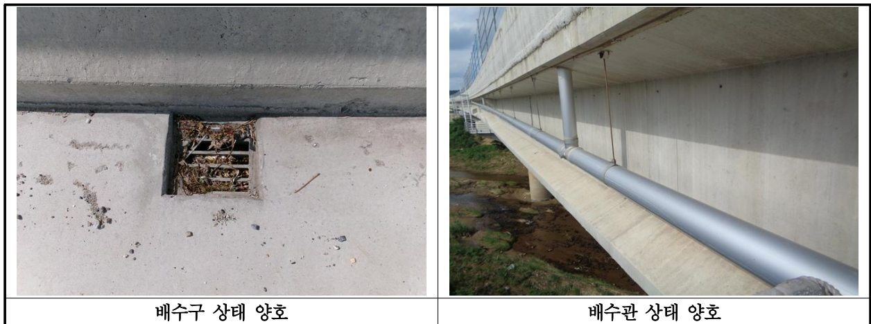
【사진 32.3.22】 배수시설 손상현황
