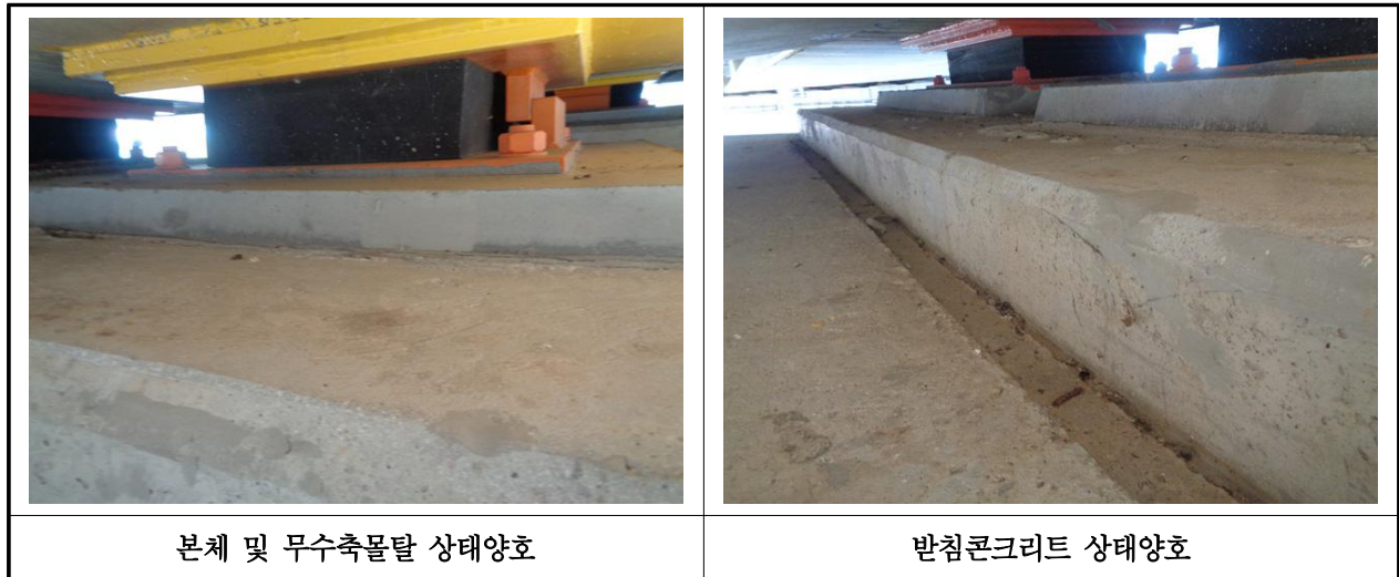
【사진 31.3.13】 교량받침 손상현황
